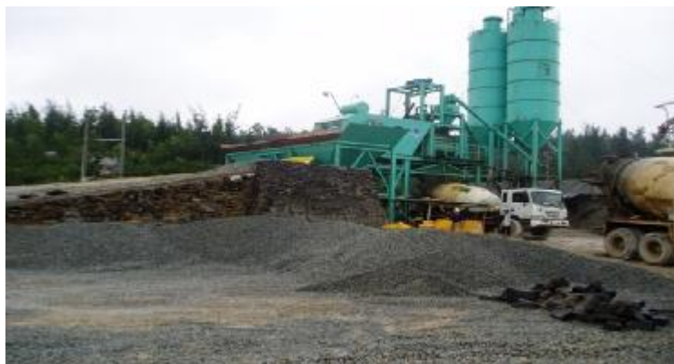
Trạm trộn bê tông số 1, 2 và Mỏ đá PVC-MT
