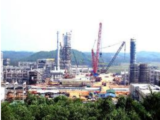
Nhà máy lọc Dầu Dung Quất
